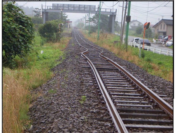
写真：飛び出たマンホール（左上） 地割れた道路（右上） 曲がりくねった線路（下）
